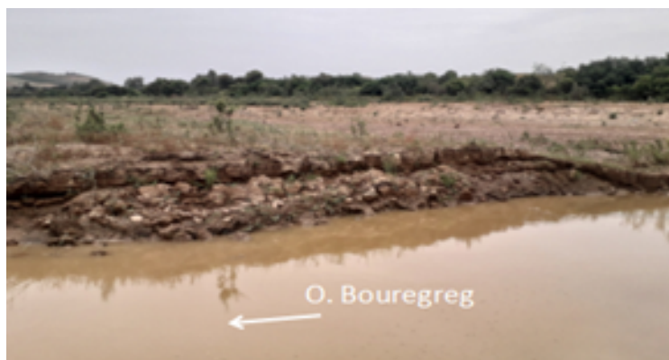
Photo 3 . Effondrement d'une berge en rive droite du Bouregreg en amont du pont de RR 407 (26/05/2021)
