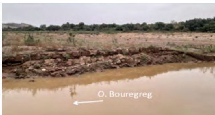
Photo 3 . Effondrement d'une berge en rive droite du Bouregreg en amont du pont de RR 407 (26/05/2021)
